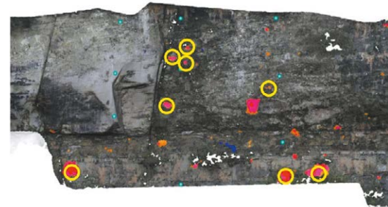
Figure 36. Inspection E1 - E2 (cercles jaunes = décrochements)
