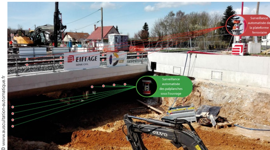
Figure 8. Auscultation automatique passage ferroviaire.
