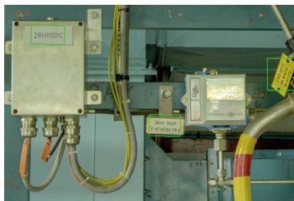
Figure 13. Matériels issus d'une photo panoramique très haute définition d'un local de la centrale de Fessenheim - Les rectangles verts montrent la détection des textes par ALBERT.
