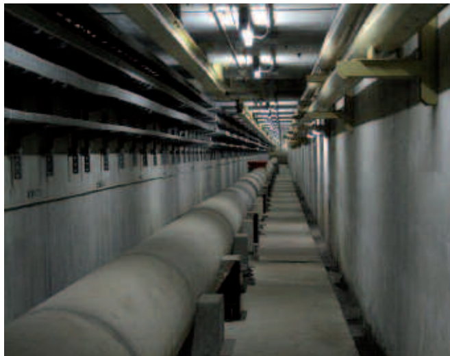
Figure 24. Galerie technique d'une centrale nucléaire
