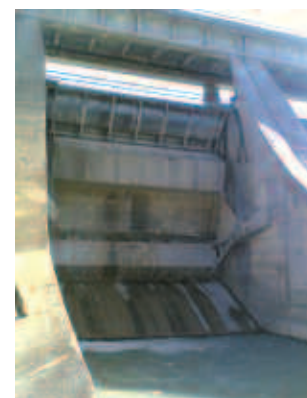
Figure 11. Vanne de barrage
